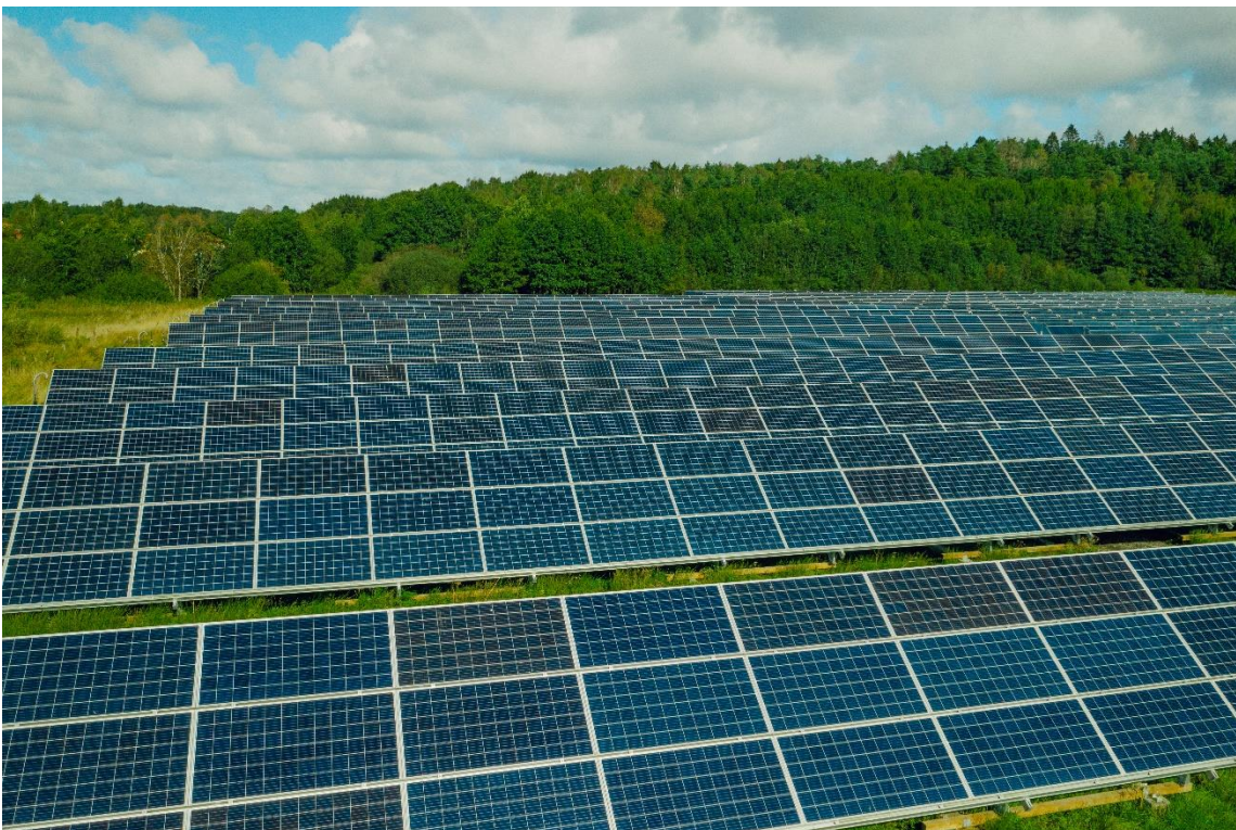
Solcellparken i Munkegårde, Kungälv, för soleldrift in på nätet. Foto: Kungälv Energi
